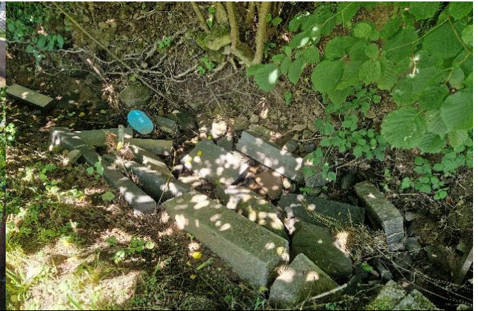
Ins Gewässerbett gestürzte Mauersegmente
