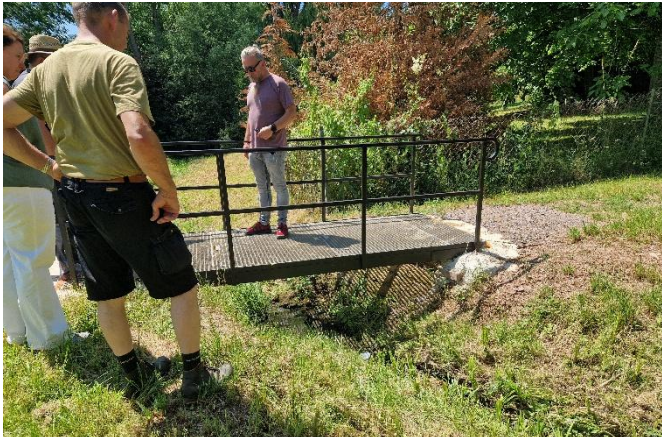
Steganlage, Blick in Fließrichtung nach Westen
