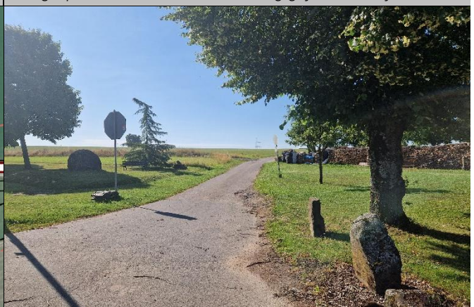
Ausgespültes Bankett durch im Weg geführten Abfluss
