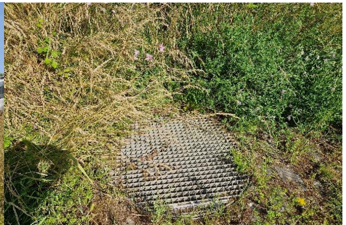
Blick Richtung Süd-West. Einlass/Überlauf mit Gitterrost
