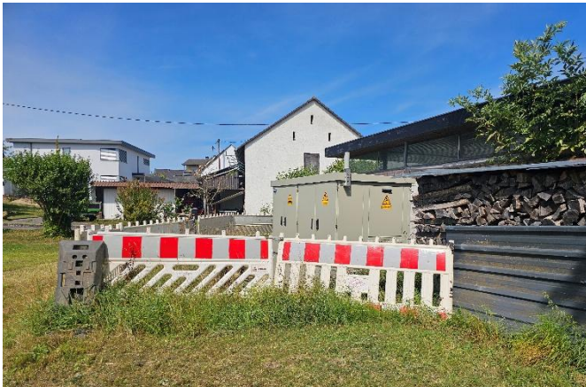
Einstaugefährdete Fläche westlich der Herforster Straße
