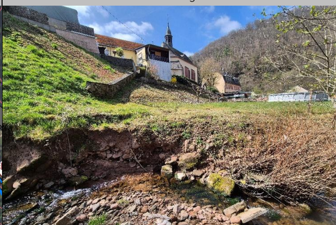
Erosion an der Gewässerböschung
