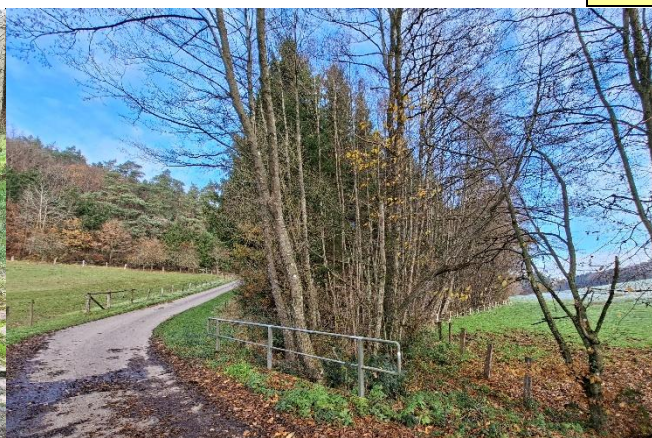
Bewuchs im Abflussprofil an einem Wegedurchlass
