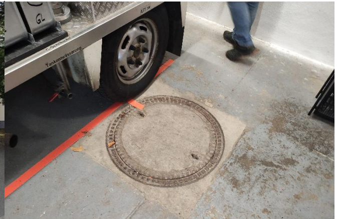
Kanaldeckel im Geräteraum des Feuerwehrhauses
