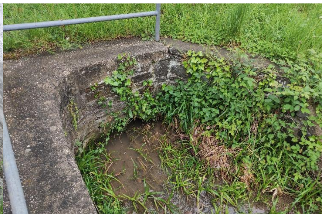
Stark zugesetzter Auslassbereich der Bachverrohrung
