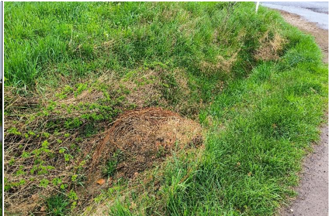
Zugewachsener Grabenabschnitt an einem Wegedurchlass
