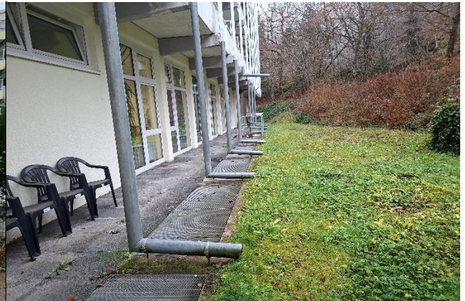
Elfenmaar-Klinik: gefährdete Lichtschächte an der Ostseite
