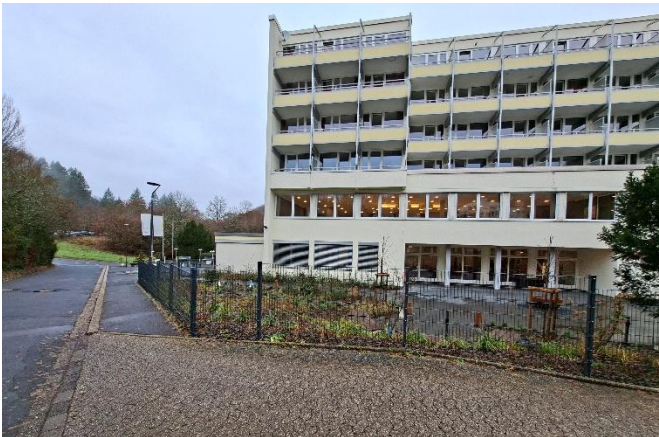
Elfenmaar-Klinik: südliche Gebäudeseite einstaugegefährdet
