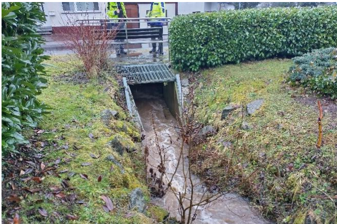
Einlassbauwerk vor der Geeser Straße aus Rtg. Königsfichte
