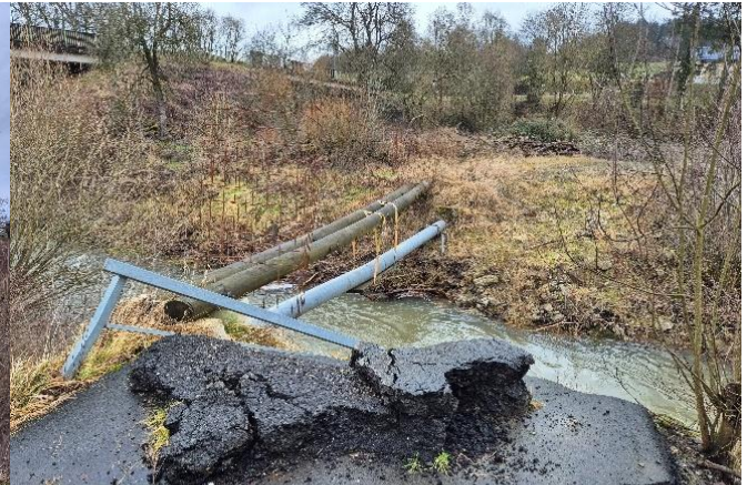
Rohrleitungen über den Oosbach: vor Neubau der Brücke
