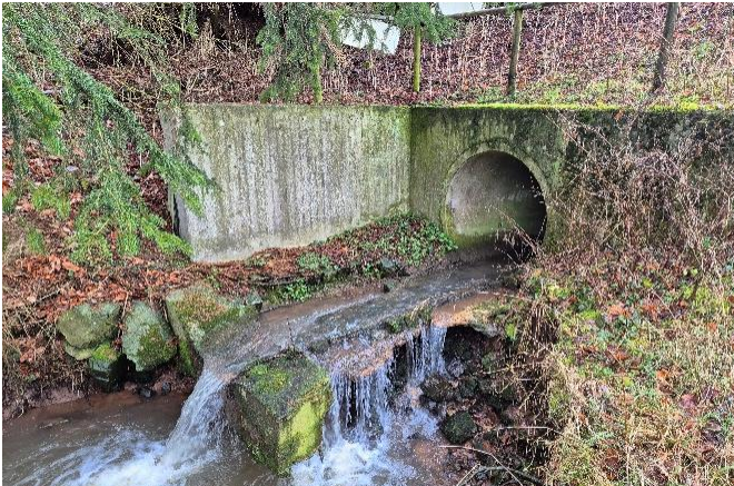
(N) Auslass der Bachverrohrung unterhalb der K33
