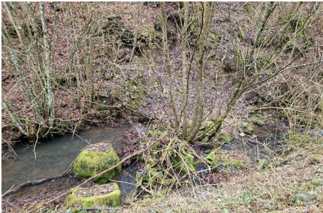
(S) Verklauung im Bach. Höhe Gerolsteiner Str. 81/83
