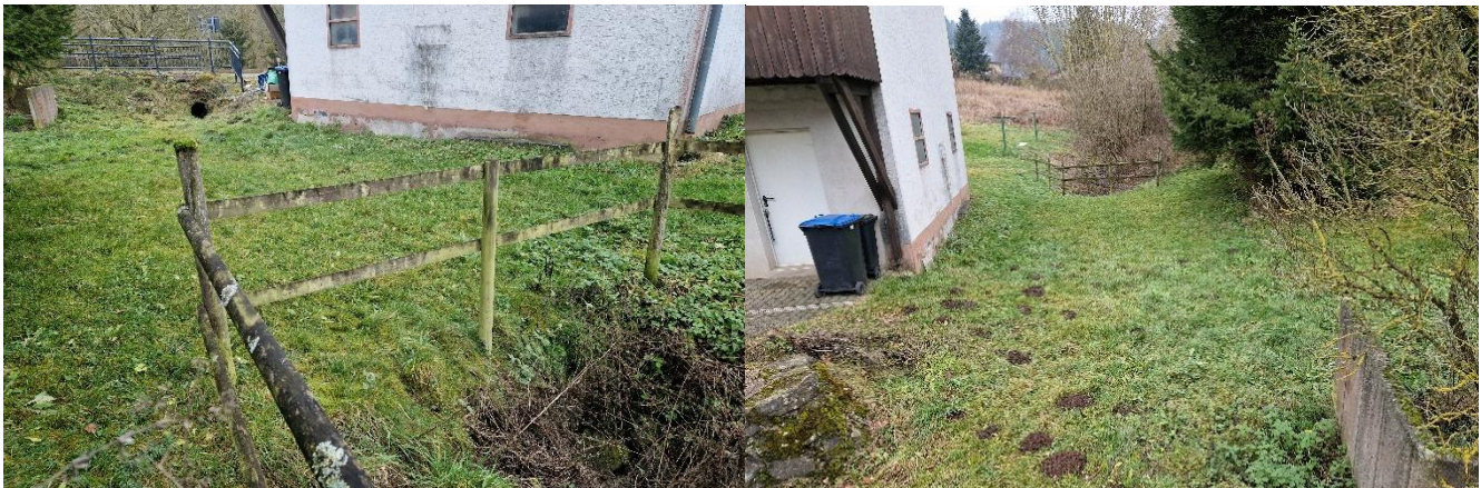
(S) B410 mit Straßenverrohrung und Einlass vor Haus Nr.46
