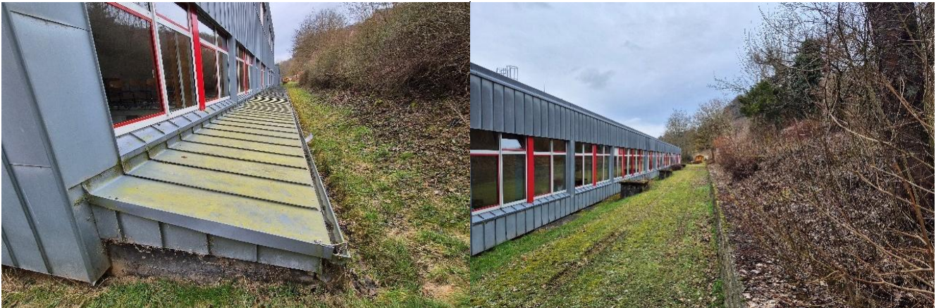
Entwässerungseinrichtungen rückseitig des Gebäudes
