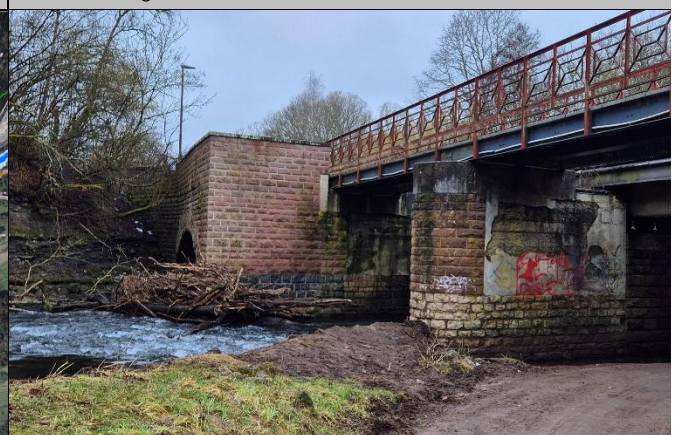
Verklausungen an der Bahnbrücke
