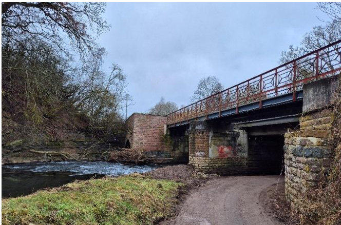
Verklauungen an der Brücke in Fließrichtung gesehen
