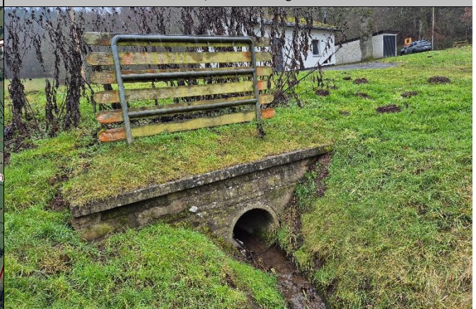
Auslass unterhalb der Str., im Hintergrund Feuerwehrhaus
