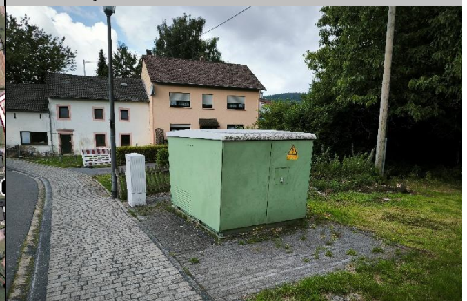
Kritische Infrastruktur in unmittelbarer Gewässernähe
