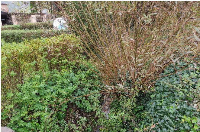
Zugewachsenes Einlassbauwerk Burgstraße
