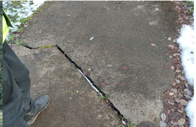
Riss im Bodenfundament des Brückenbauwerkes
