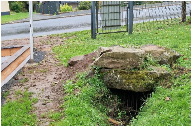
Einlassbauwerk am Dorfgemeinschaftshaus
