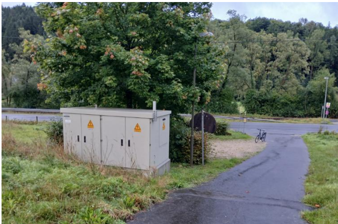
Neue Ortsnetzstation am P&R-Parkplatz
