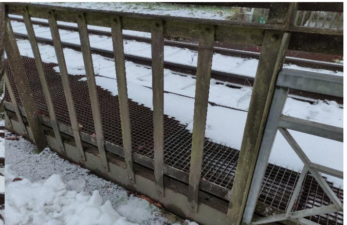
Blick auf Kläranlage mit ungesichertem Bodengitter
