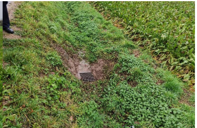
Rost-Anlage im Wegegraben nördlich der L34
