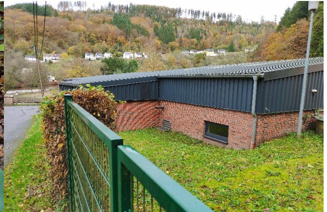
Blick auf Kläranlage mit ungesichertem Bodengitter
