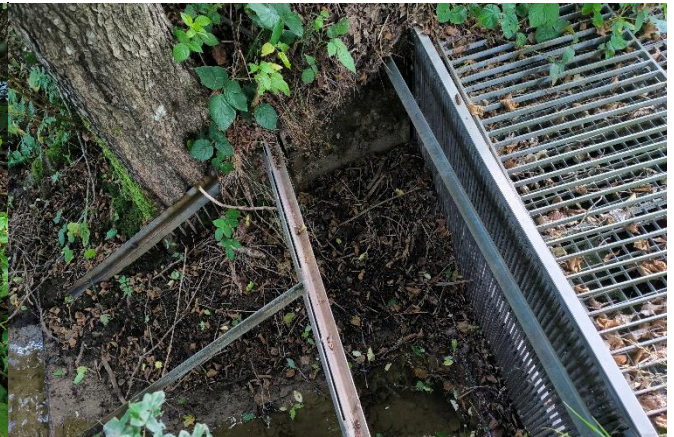
Blick auf das marode Einlassbauwerk
