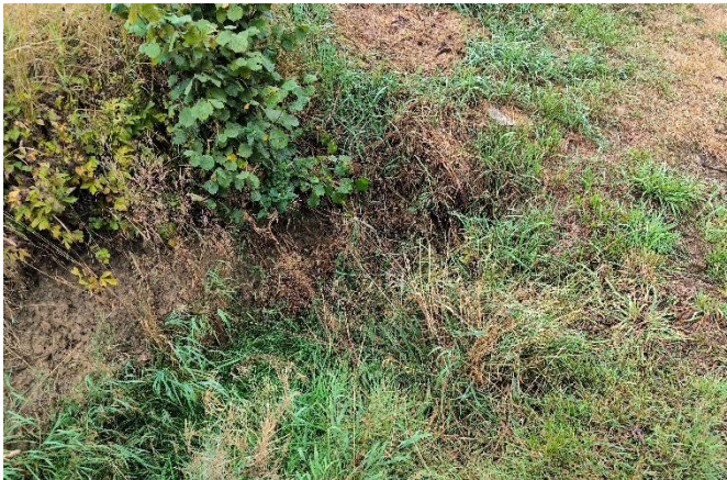
Zugesetztes Einlassbauwerk im Bereich d. Dorfstraße
