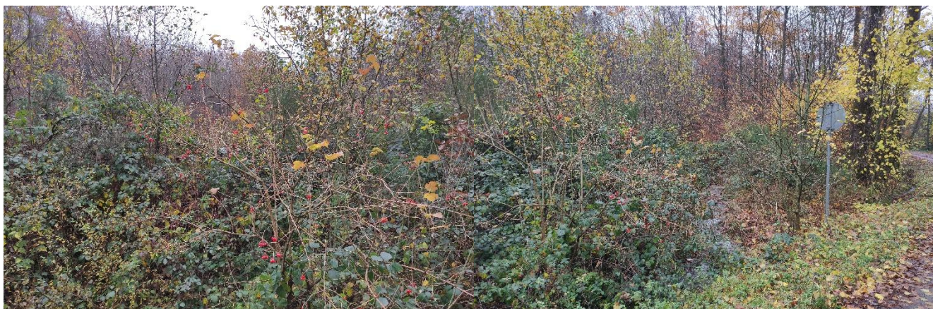
Zugewachsene Damm-Mauer der Weiheranlage
