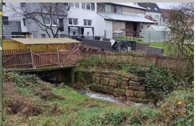
Unterspülter Mauerbereich am Auslassbauwerk
