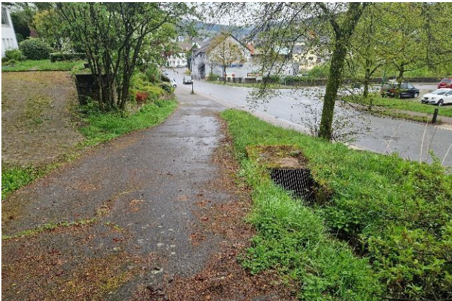
Zugewachsener Graben und Einlassbauwerk Trierer Str. 9
