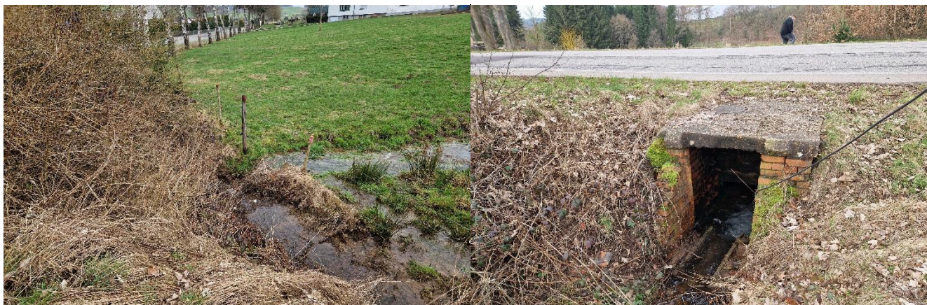
Zugewachsener Einlassbereich am Durchlass der B 268
