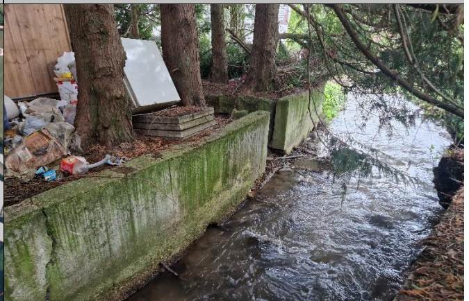
Verengter, zugewachsener Abschnitt, marode Ufermauern
