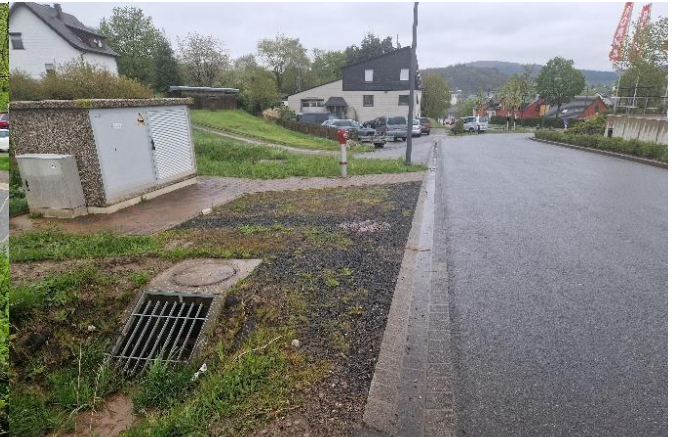
Eines der Einlassbauwerke auf Höhe des NORMA-Markts
