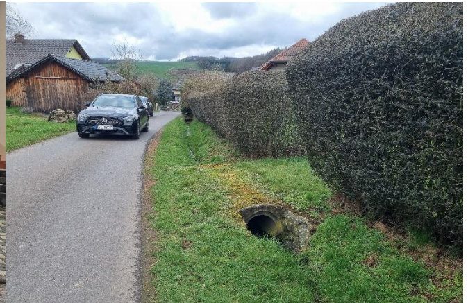
Durchlass im Entwässerungsgraben am Wirtschaftsweg
