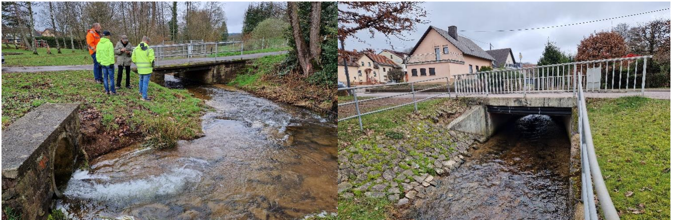
Auslass RW-Kanal vor Brücke zw. Haupt- und Hochwaldstr.
