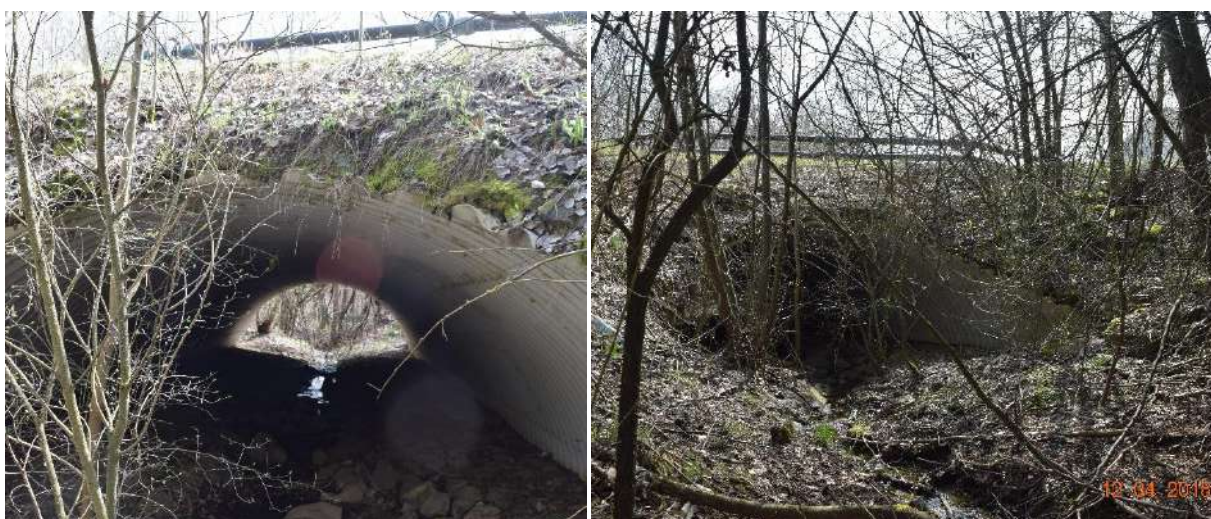
Abb. 8: Nadelwaldgraben am Durchlass Konrad-Zuse-Straße (in Fließrichtung)
